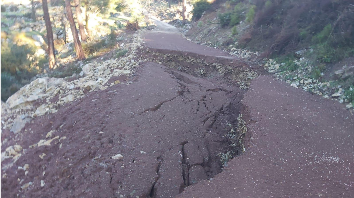
İlgi Fotoğraf: Demirciler Mahallesi heyelan olmuş yolun ilk hali.
